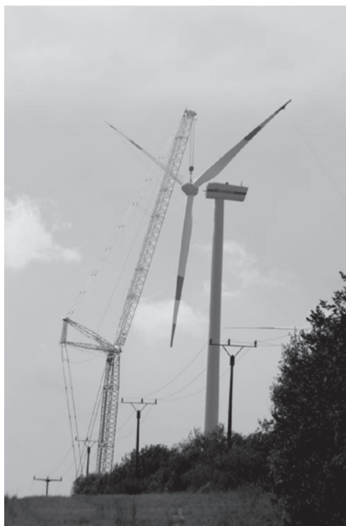
Foto: Frank Küchler
